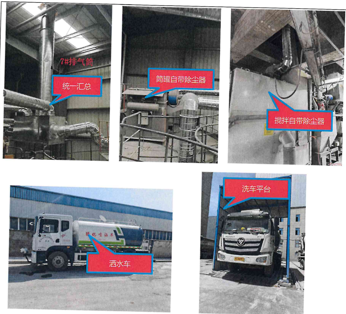
图 3-2 废气处理工艺现场照片
