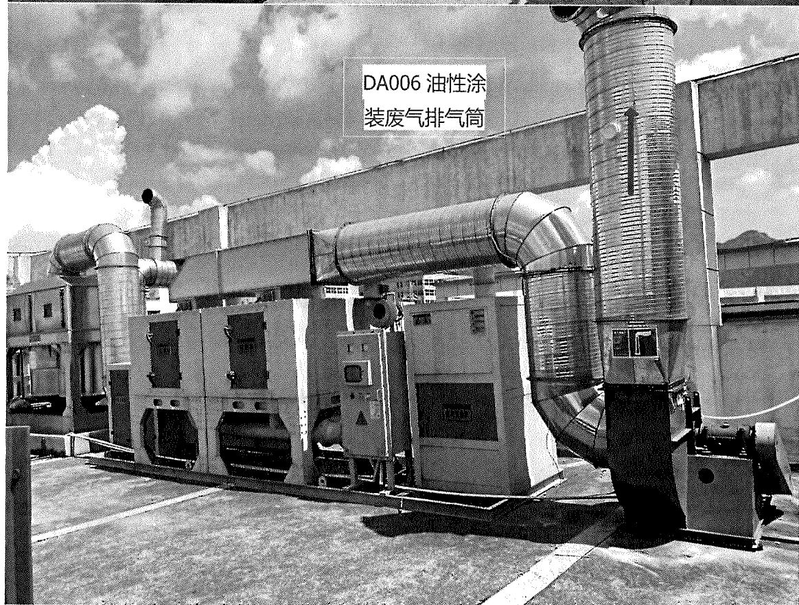
图 3-4 油性涂装废气 DA001、DA002、DA006 现场照片
