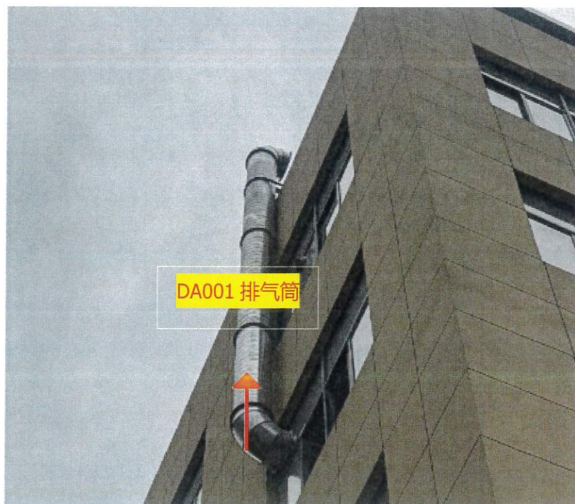
图 3-4 上胶粉尘废气 DA001 现场照片
