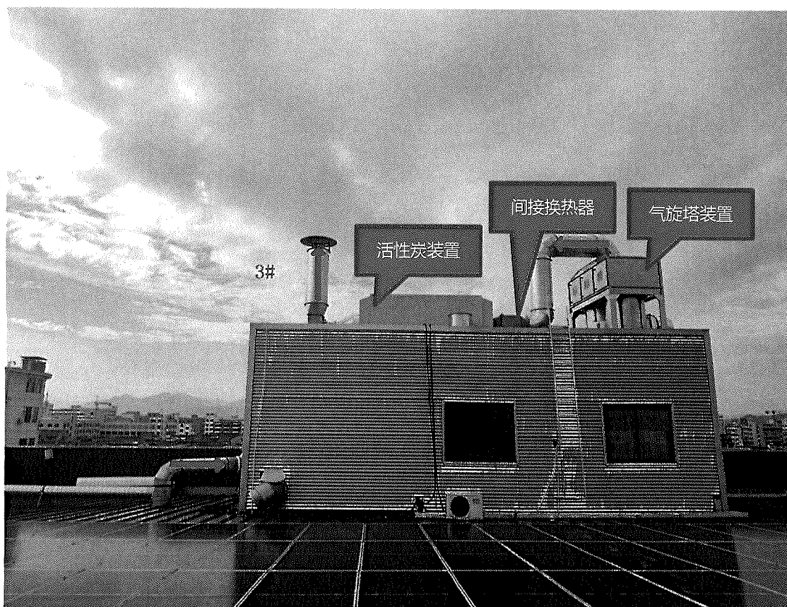
图 3-3 抽真空、固化及喷漆固化废气处理工艺现场照片
