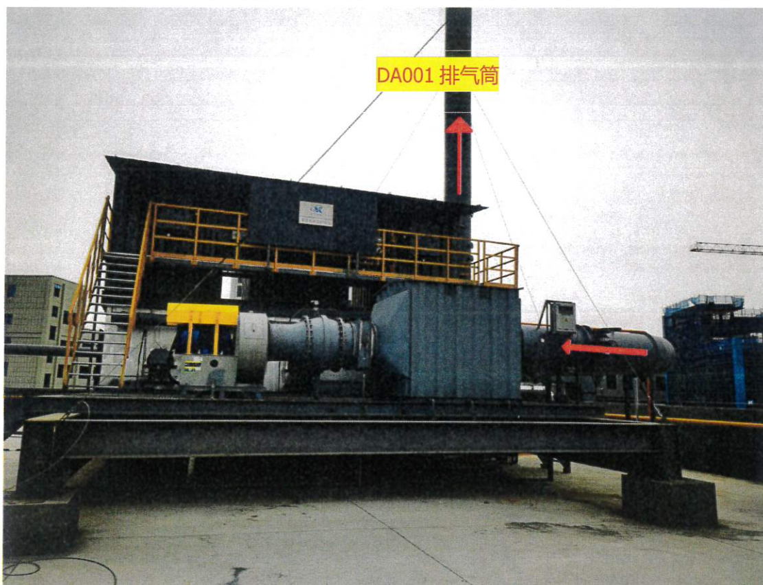
图 3-3 涂装废气 DA001 现场照片
