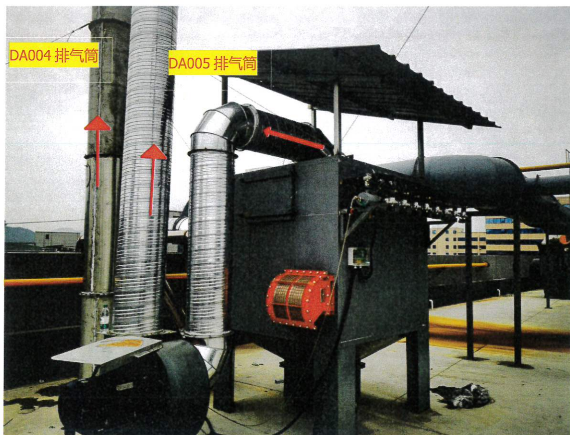
图 3-6 天然气燃烧 DA004、喷塑粉尘 DA005 现场照片
